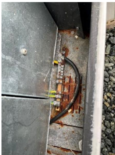
Begynnande korrosjon av tilknytningsskap
